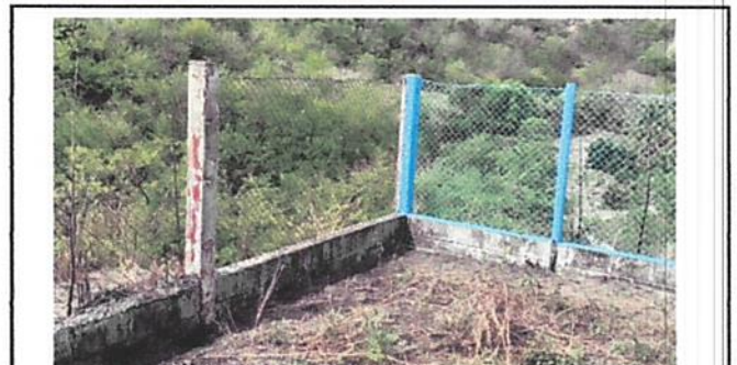
Foto 6: El porton de ingreso se encuentra en mal estado
