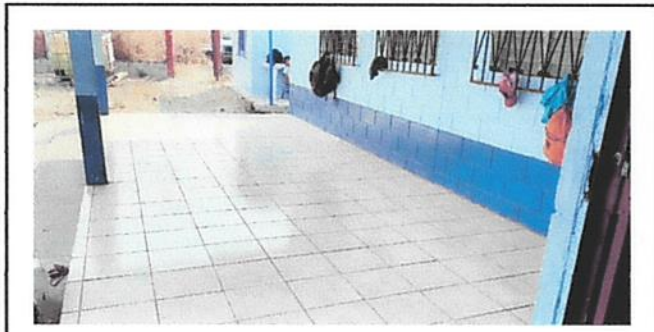
Foto 5: Piso de aulas y corredor en mal estado
