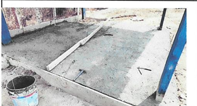
Foto 3: Torta de cemento deteriorada donde se encuentra la pila
